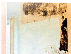
Unter der Tapete entdeckt: große Schimmelflecken an der Wand
